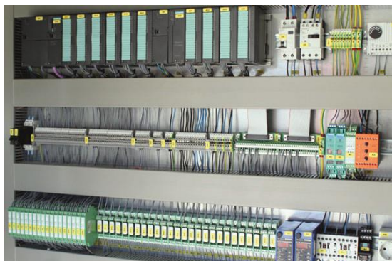
Schaltschrank mit SPS-Steuerung
