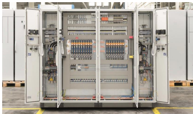
Schaltschrank mit Leistungsteil
